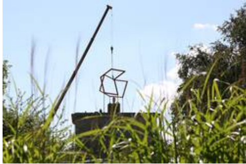
Fest zusammengebaut und frisch lackiert geht es ab auf's Bunkerdach (Foto: Denise Walter)
